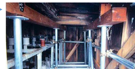
2 埋設ケーブル区間にある 2.8 合ハット内部が腐食し天井倒壊の恐れがあるため支柱で補強
